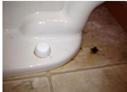
Dirty Toilet Base
